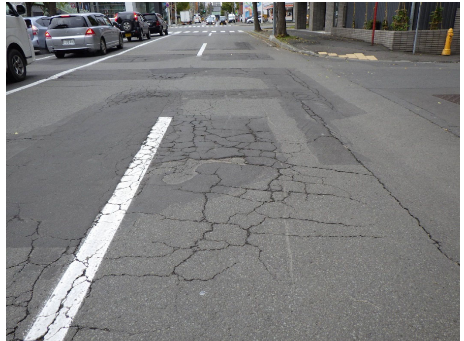
パッチングの破損状況
