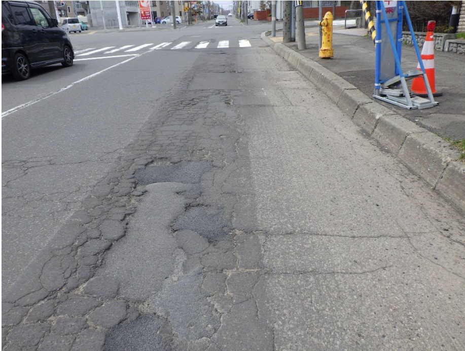
パッチングの破損状況
