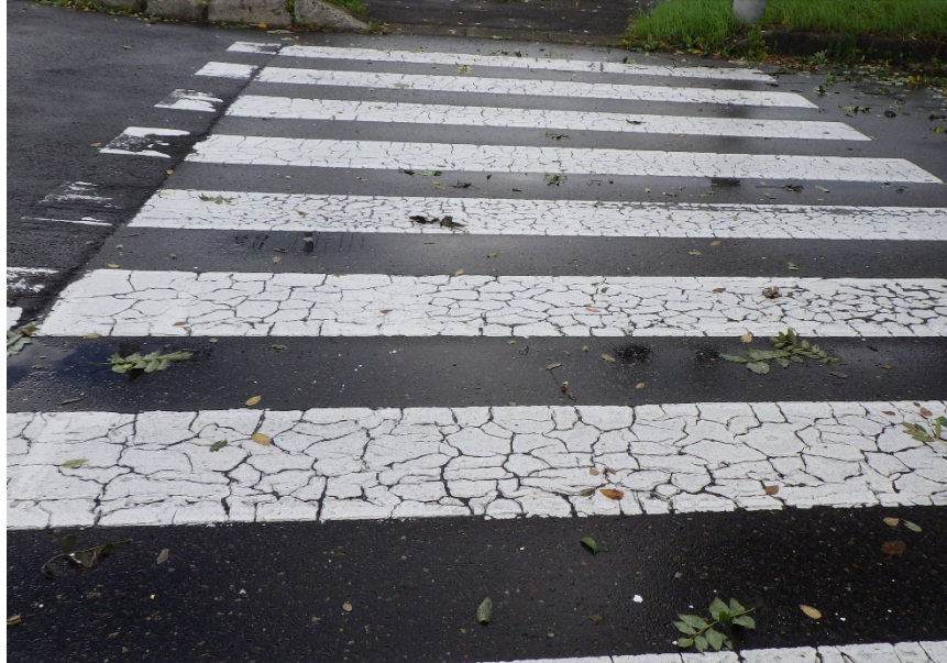
横断歩道の区画線の破損状況
