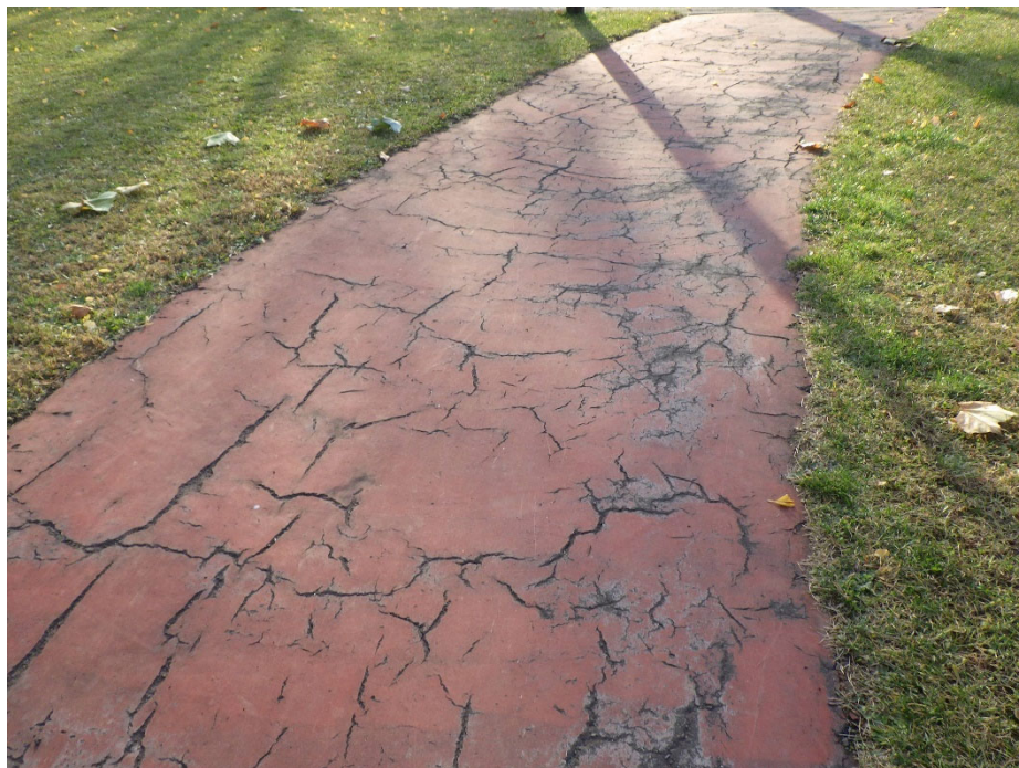
カラー舗装の破損状況
