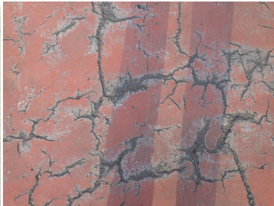
カラー舗装の破損状況(接写)
