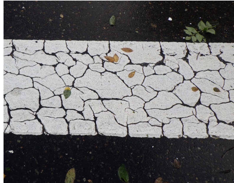
横断歩道の区画線の破損状況(接写)
