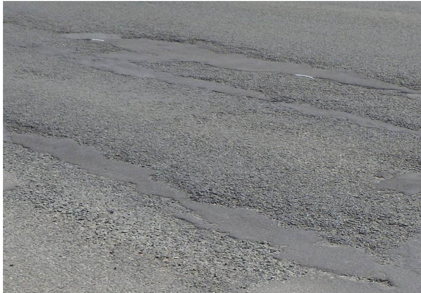
排水性舗装の骨材飛散の状況
