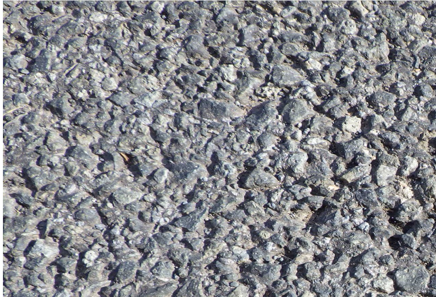
排水性舗装の空隙づまりの状況
