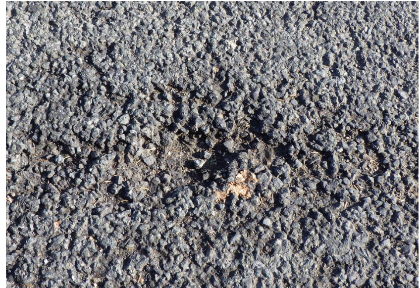
排水性舗装の骨材飛散の状況
