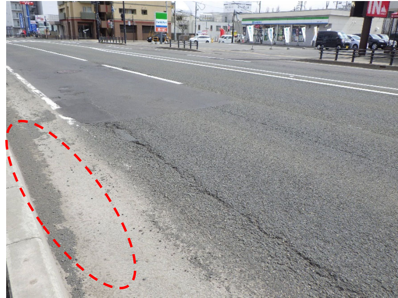
排水性舗装の骨材飛散状況
