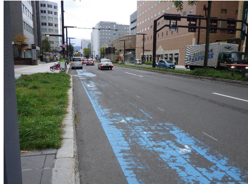
除雪車により削られたカラー舗装
