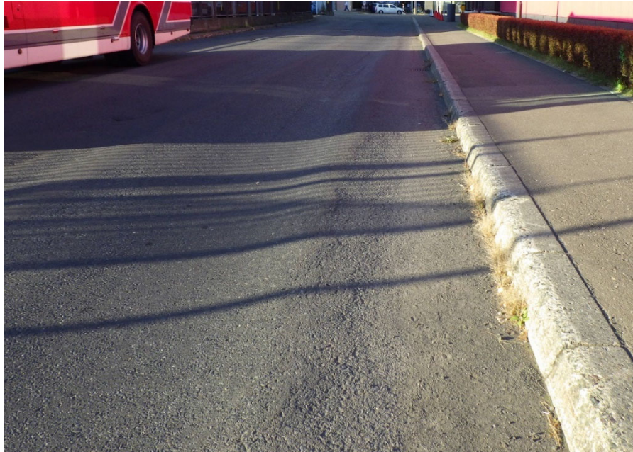
わだち掘れの状況
