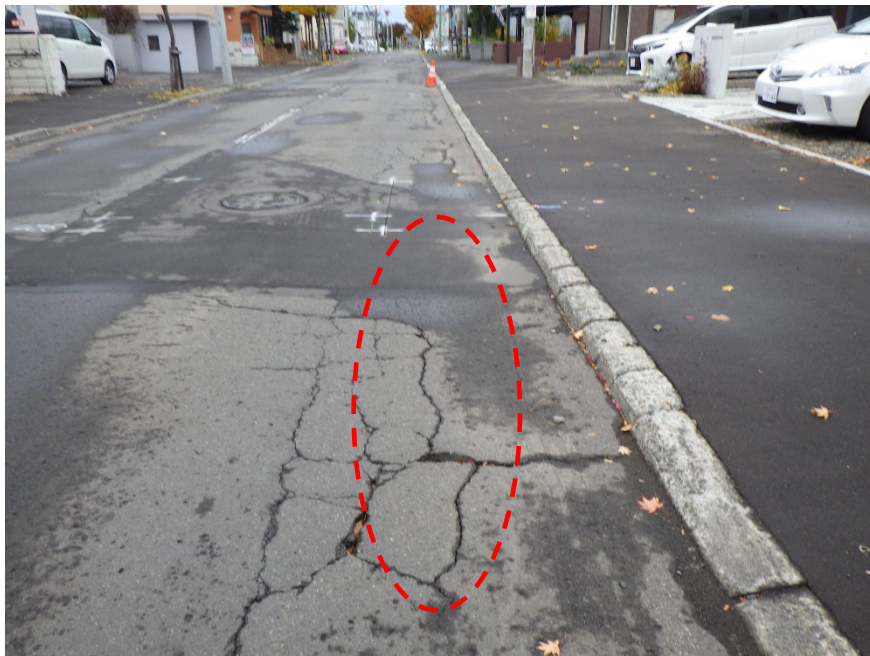
わだち掘れの状況
