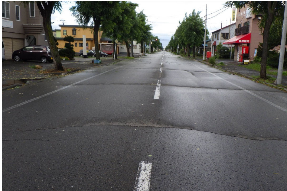
温度応力ひび割れの状況
