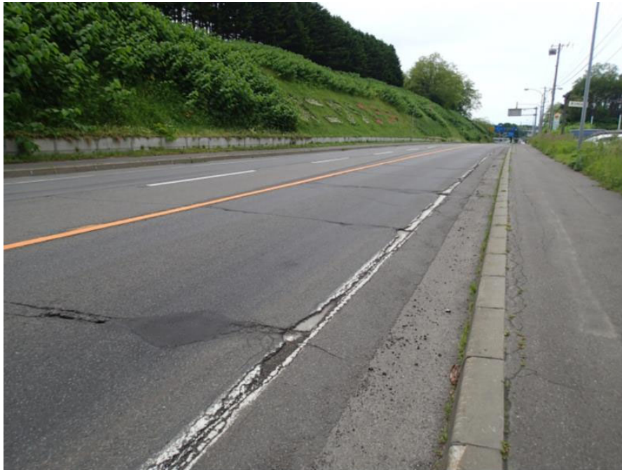
リフレクションクラックの状況
