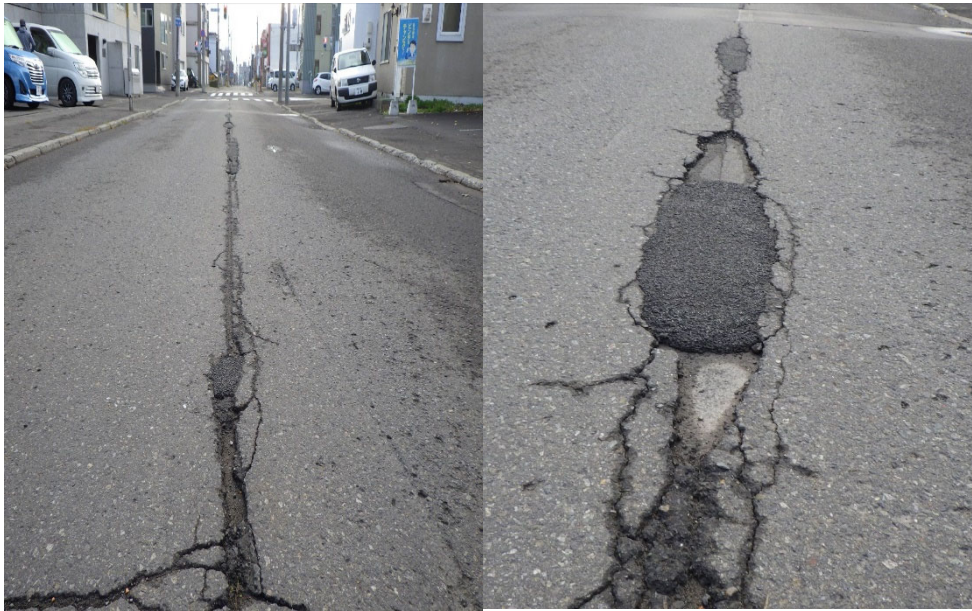
施工継ぎ目のひび割れ（縦方向）の状況
