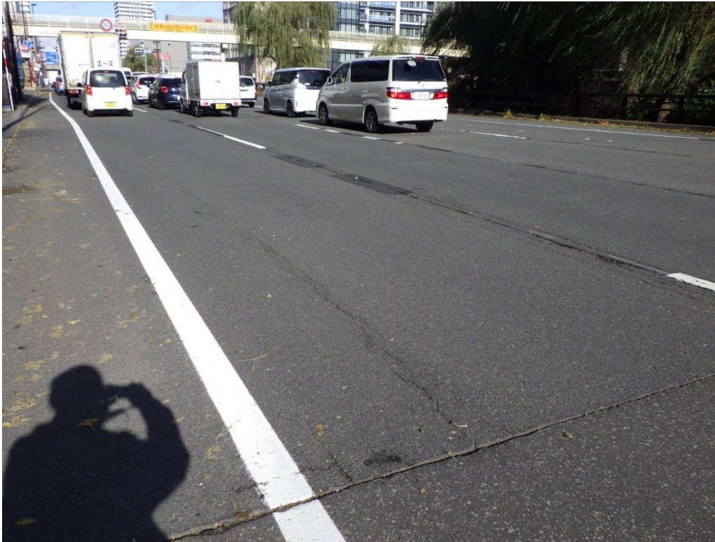
わだち割れの状況
