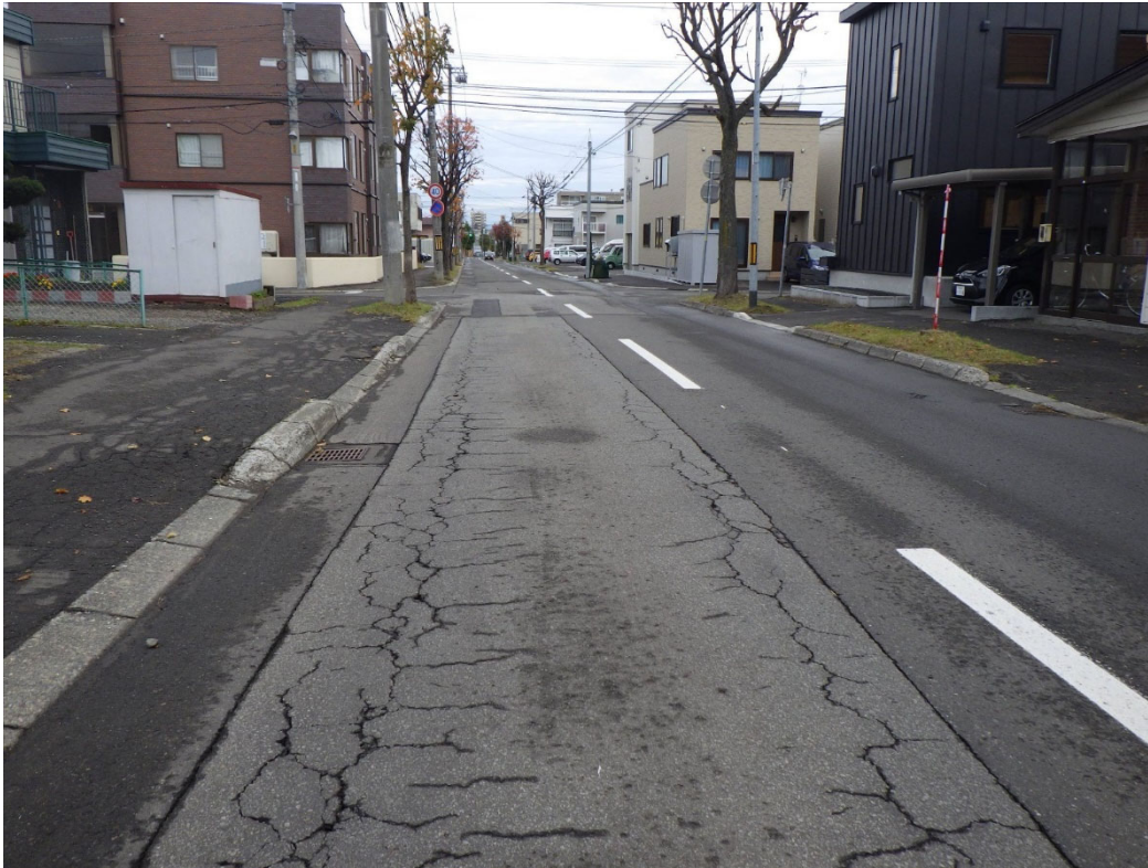
疲労ひび割れの状況
