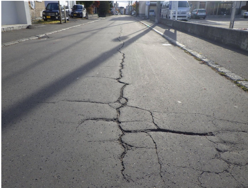
凍上によるひび割れ
